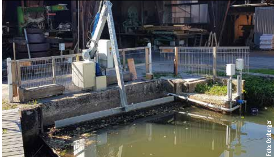
Der mittelfränkische Wasserkraftexperte Ossberger lieferte die komplette elektromechanische und stahlwasserbauliche Ausstattung für die Modernisierung der Anlage Benz II im Schwarzwald. Eine pegelgeregelte Rechenreinigungsmaschine sorgt bereits seit Ende 2017 für optimale Zuflussbedingungen am Kraftwerkseinlauf.
