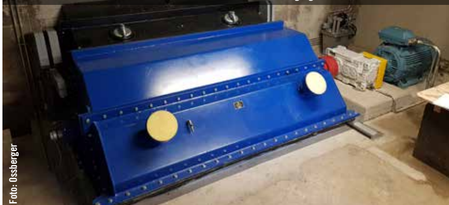
Bei vollem Wasserdargebot erreicht die Ossberger-Turbine eine Engpassleistung von 51 kW, darüber hinaus kann die Maschine ihre Stärken vor allem bei variierenden Zuflussbedingungen unter Beweis stellen.
